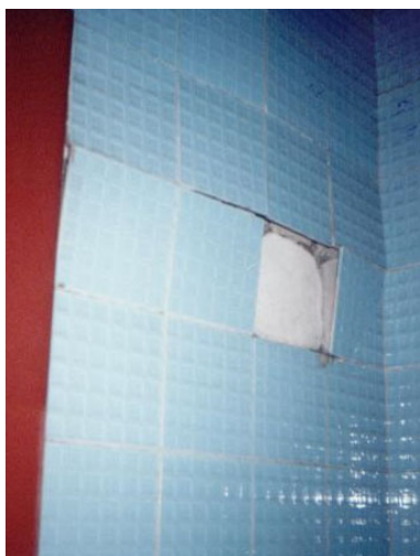
(a) Descolamento em revestimentos internos
