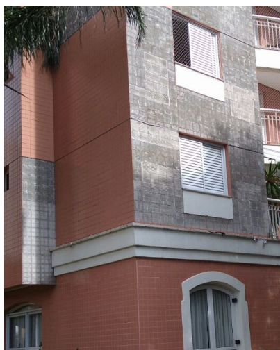
(b) Descolamento em revestimentos externos
