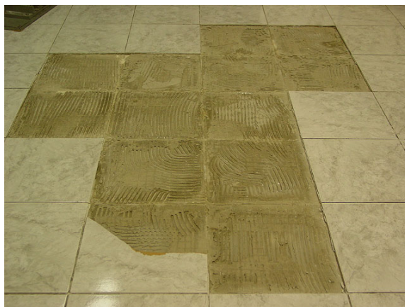
(c) Descolamento em pisos internos
